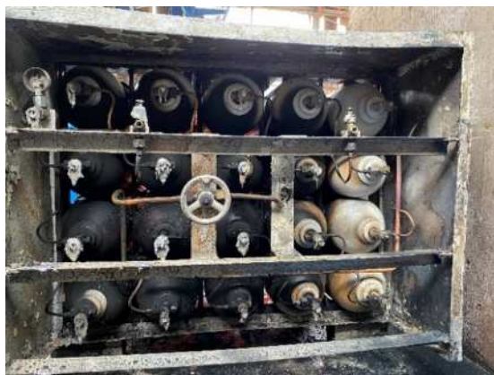
事故を起こしたカードル（前面）
