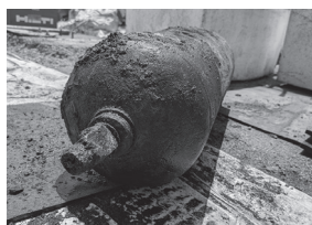
工事現場で掘削時に 掘り出された容器
